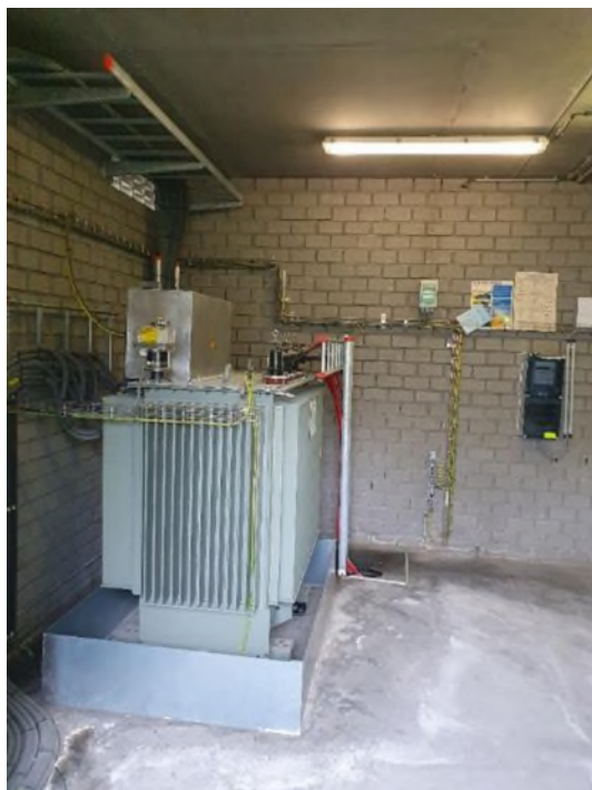
Figure 20 Transformateur à l'huile sur bac de rétention
